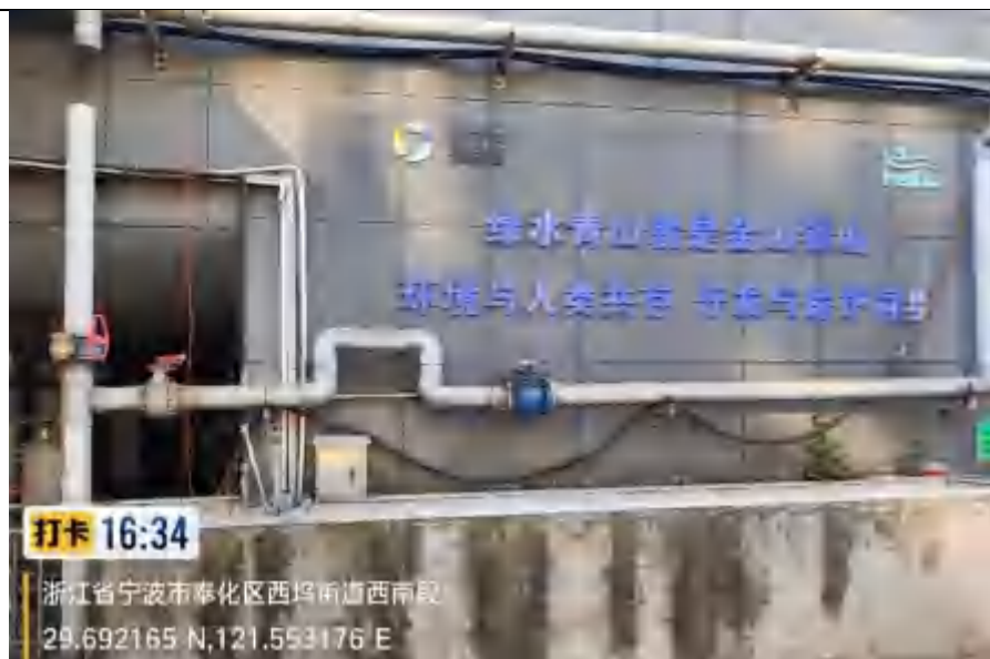
生产废水治理设施及排放口
